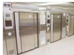
高圧蒸気滅菌装置
